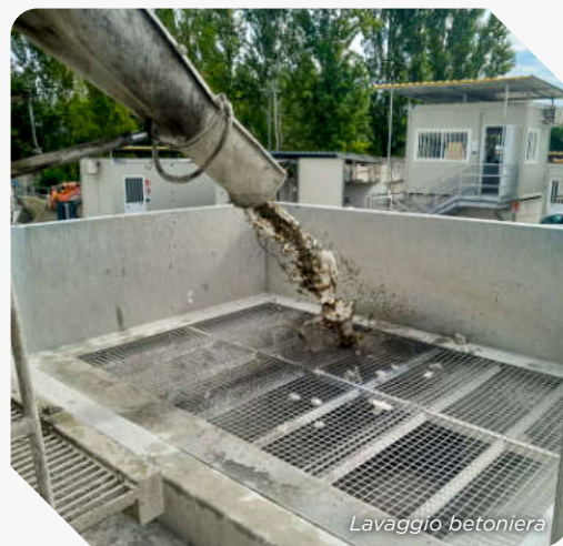
Sistema di recupero acqua betoniera
