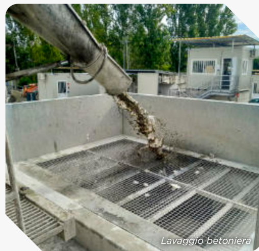
Sistema di recupero acqua betoniera
