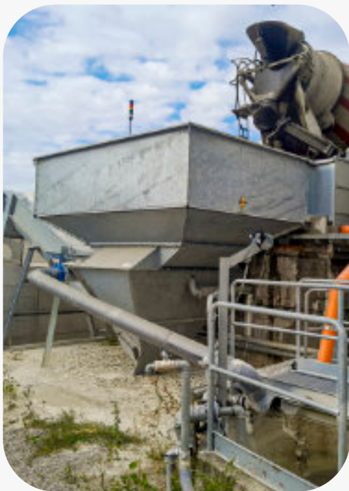
Sistema di recupero acqua betoniera
