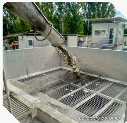
Sistema di recupero acqua betoniera
